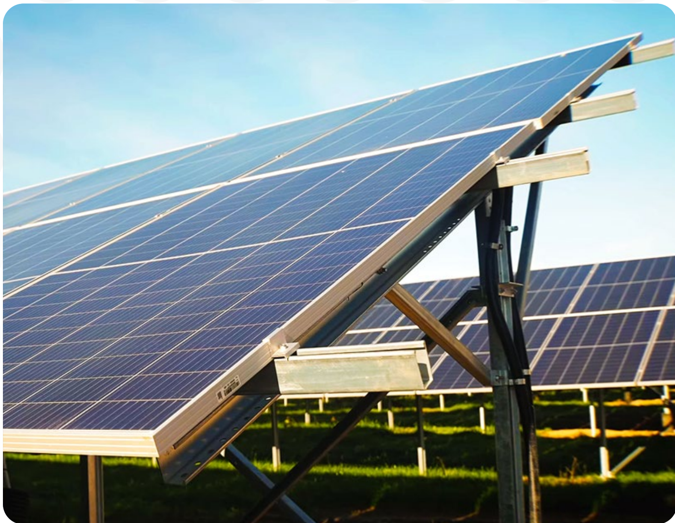
Foto dell'impianto dopo l'installazione del sistema fotovoltaico 3SUN
